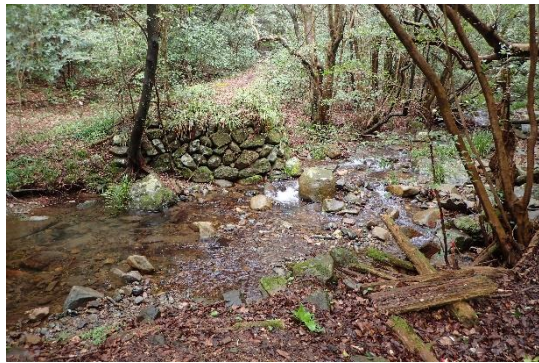
橋が崩落して渡れない 11時03分
